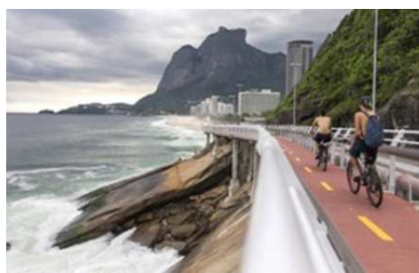
Fig. 4: Ciclovía na Av. Niemeyer, trecho que desabou em 21/04/2016, RJ
